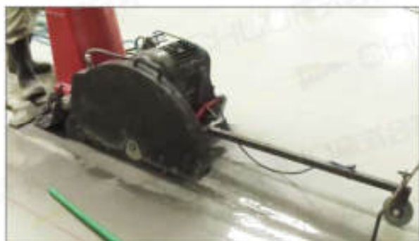
冷却水を使いながら使用すれば粉塵も削減しながら作業が出来ます。
