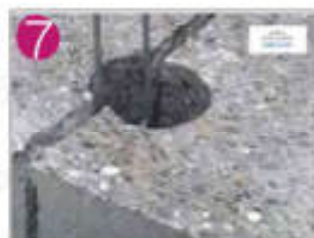
7 コンクリートにクラックが入る
